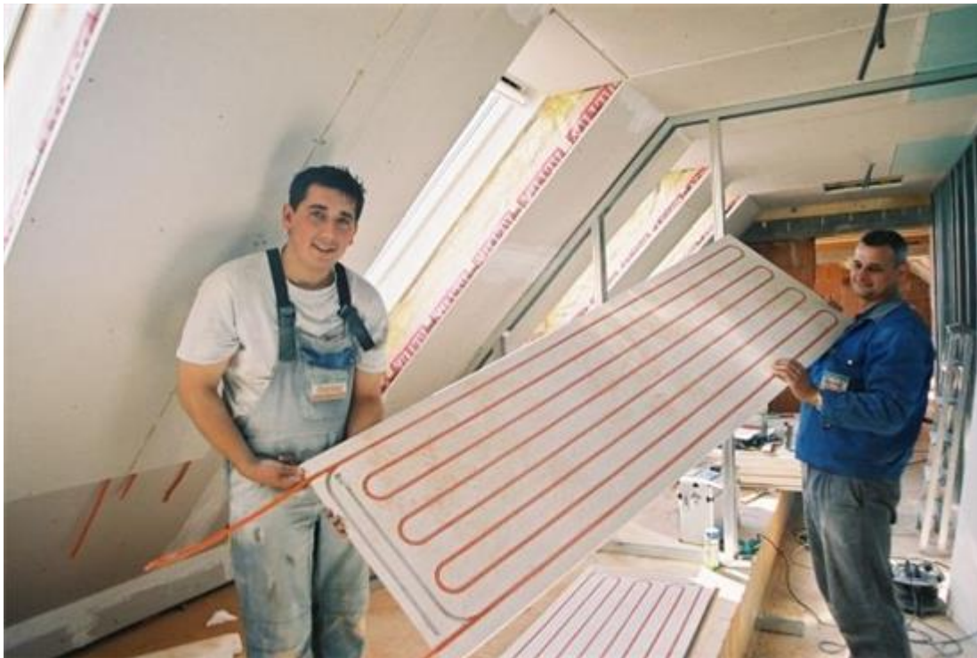
Afbeelding 5: Van binnenuit geïsoleerd dak met geïntegreerde Laag-Temperatuur wandverwarming/koeling [Bron: Technea]
